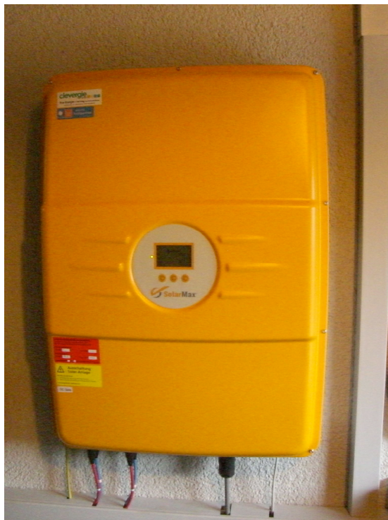
Abb. 3: Wechselrichter in der Garage
