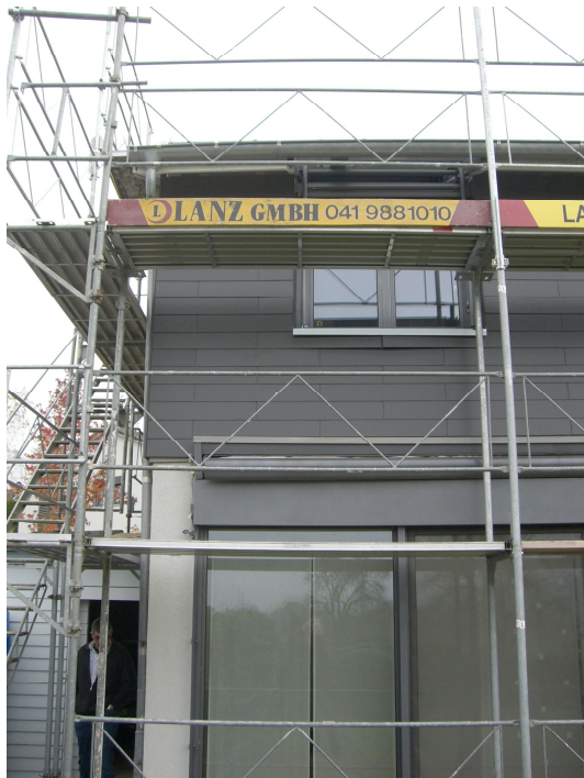
Abb. 1: Rückseite des Wohnhauses der Fam. Röösl in Mauensee, einem Vorort von Sursee. Die Solaranlage befindet sich auf dem Dach, der Wechselrichter links unten in der Garage.
